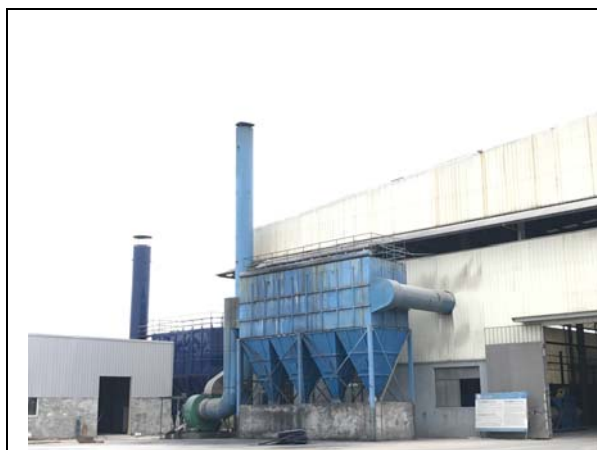
熔铸车间除尘装置、铝灰处理除尘装置及排气筒
