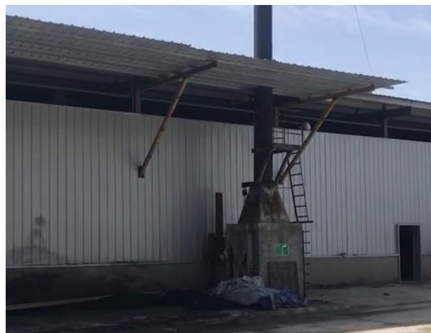
一般固废暂存点
