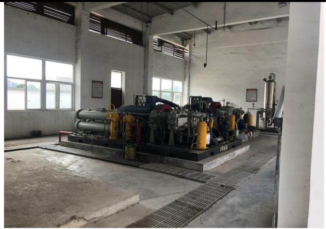
压缩机机房隔音及基座减震
