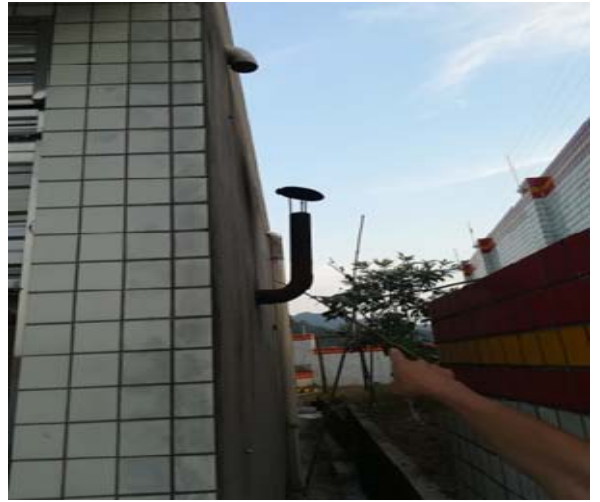
发电机废气排气筒
