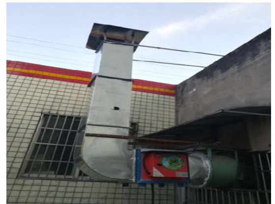
食堂油烟净化器及排气筒
