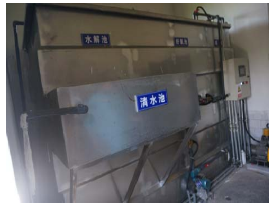
生活污水处理装置
