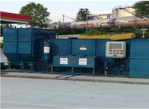
库区污水处理装置
