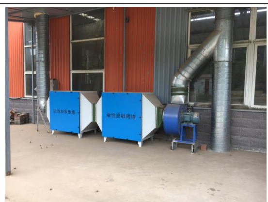
废气处理设施
