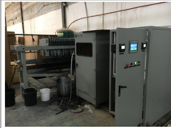
废水处理设施
