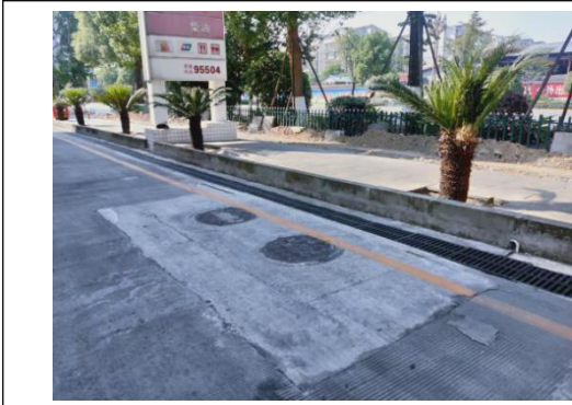
环保沟及隔油池
