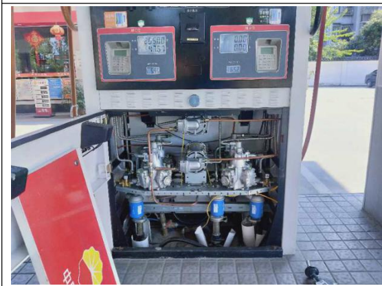
加油机油气回收
