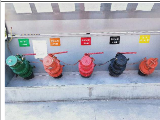
卸油口油气回收
